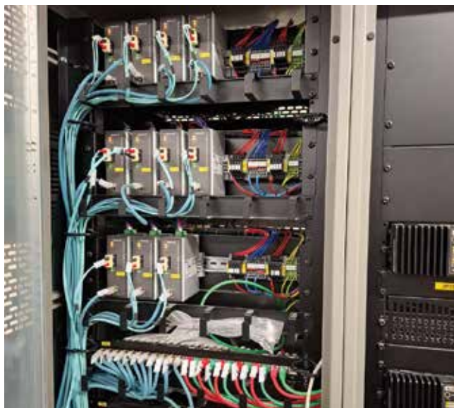
Súčasťou architektúry riadenia technologických procesov sú moderné priemerné komunikačné prvky aj pokročilé systémy procesného riadenia.
