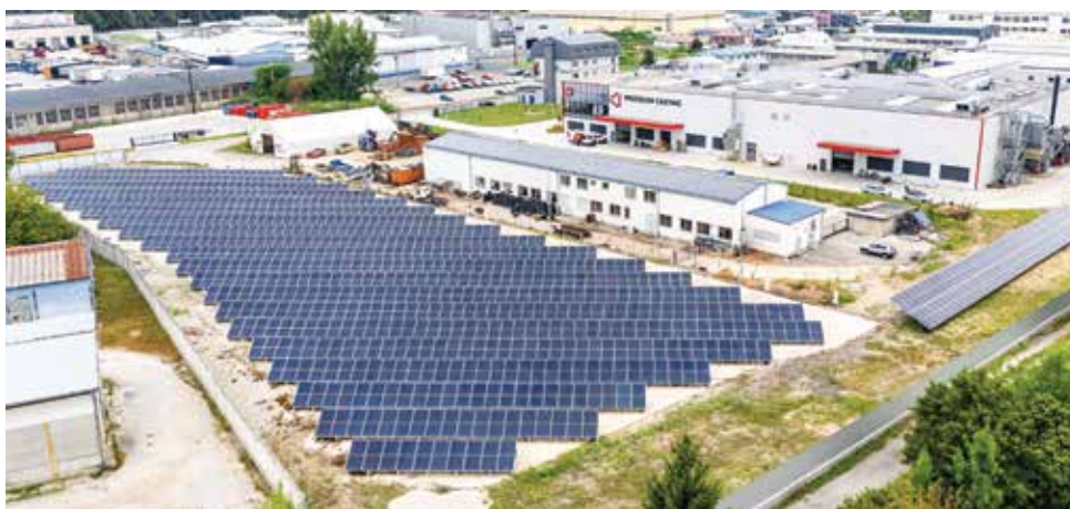
Fotovoltická elektráreň v spoločnosti Medeko Cast, s.r.o.
